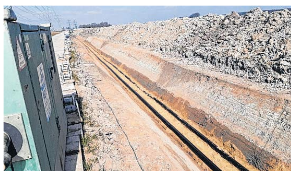
Das Kabelpaar liegt in der Regel 1,60 Meter tief. Die reine Bauzeit dauerte 12 Monate, die Vorbereitung viel länger.
